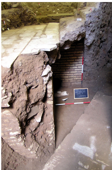
Fig. 45. Ambiente X. Vano al di sotto della scala rivestita in marmo, con fistula plumbea sul fondo, da est. Foto di S. Barrano, luglio 2009.
